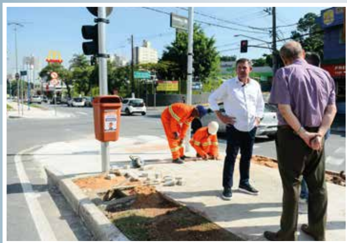
Orlando Morando, prefeito de São Bernardo do Campo, vistoria obras da ciclovia da Prestes Maia
